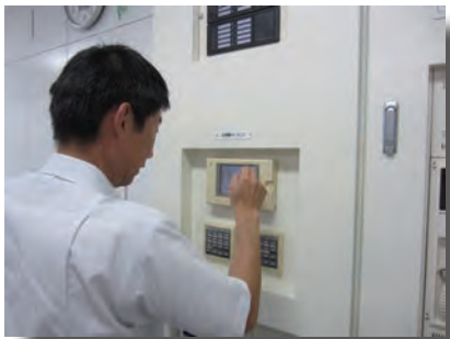
空調機の遠隔操作の様子
