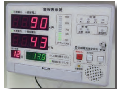
デマンド監視システム
