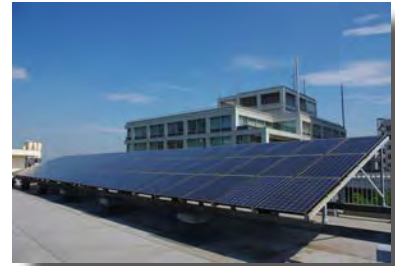
太陽光発電設備
